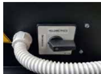
Umschalter Feld- und Einspeisebetrieb.
